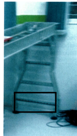
Figura 53: Local de corte na esteira Fonte: Autores
