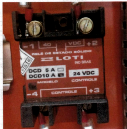
Figura 32: Relé Loti Fonte: Autores
