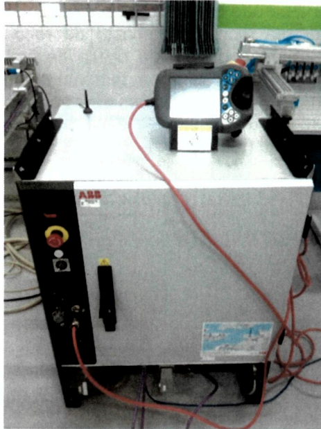
Fig 37: Painel de acionamento e controle Fonte: Autores
