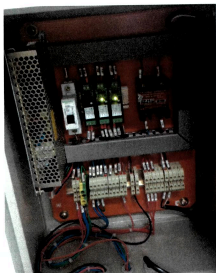
Figura 68: Painel elétrico 2 Fonte: Autores
