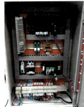
Figura 67: Painel elétrico 1 Fonte: Autores
