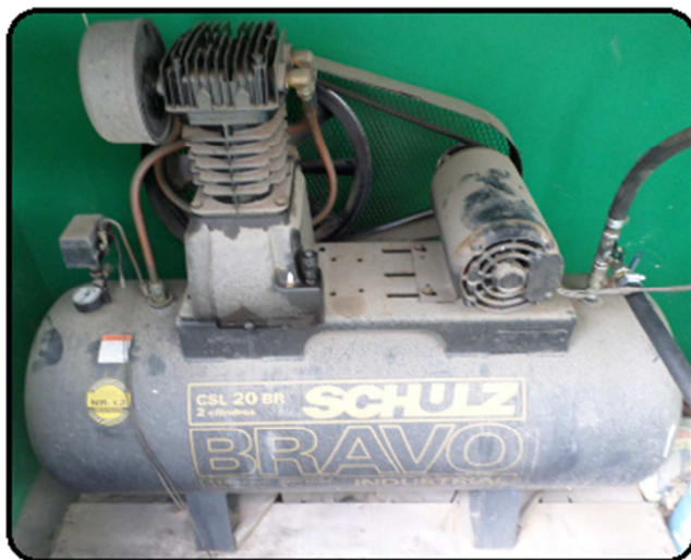
FIGURA 1 - Compressor de ar
