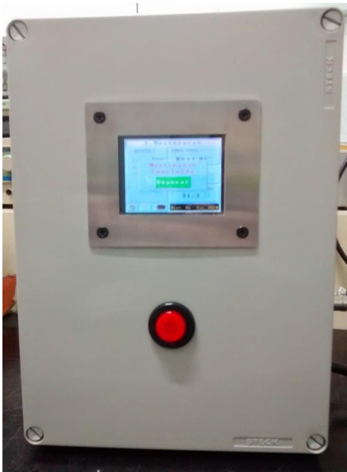
FIGURA 51 – Vista frontal do painel elétrico fechado
